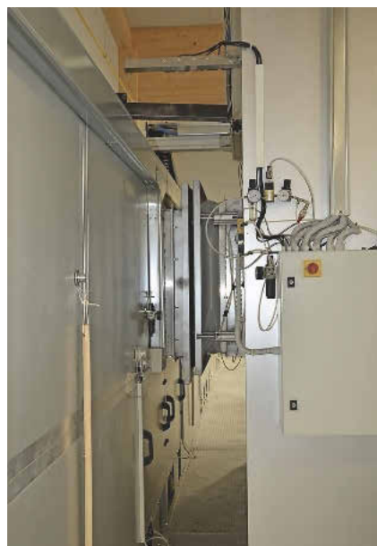
An jeder der fünf möglichen Positionen der Kabine kann über eine Dockingstation Zuluft entnommen werden.
