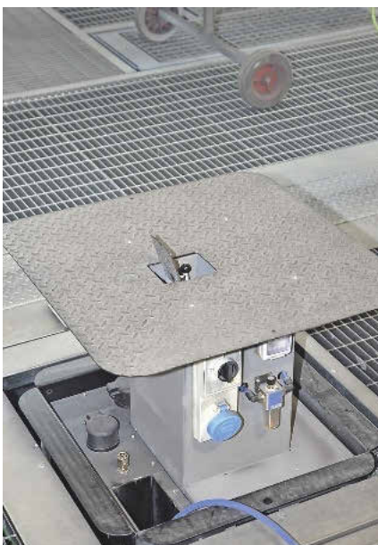
Energieampeln sind in den Kabinenboden versenkt worden, sodass die Beweglichkeit der Kabine nicht beeinträchtigt wird.
